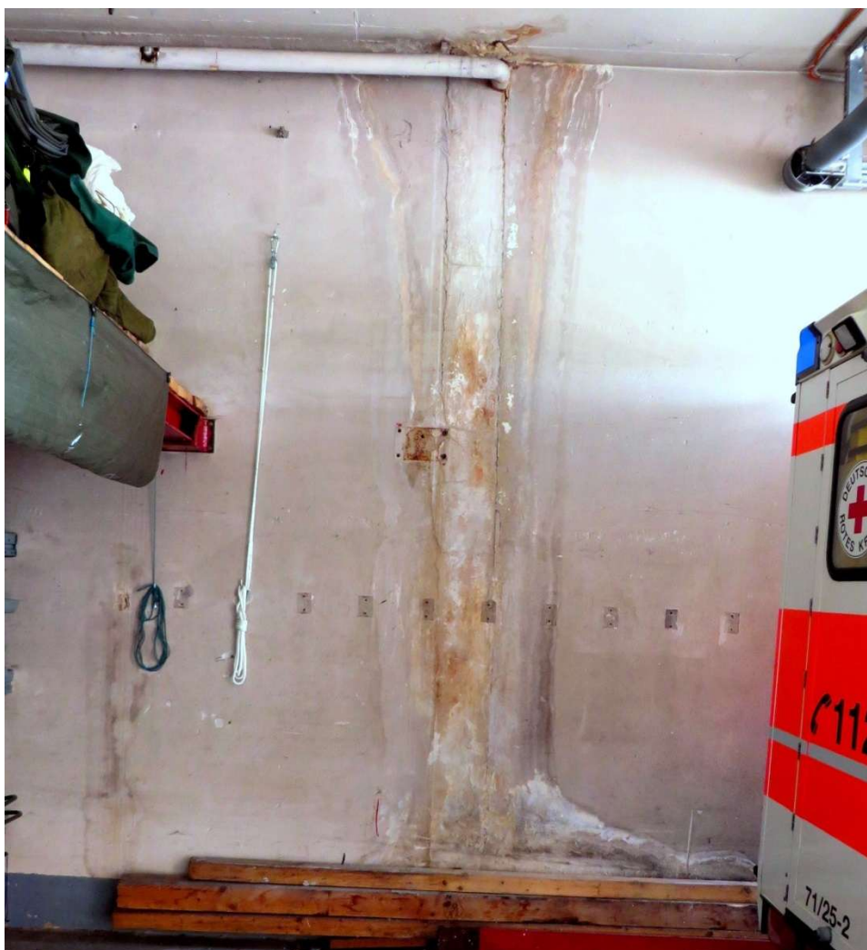
Fast schon symbolisch für den Sanierungsbedarf am Albert-Schweitzer-Haus, dem Vereinsheim des DRK-Ortsvereins Sindelfingen – der Wasserschaden 2023
